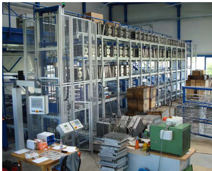
Zu- und Abführung inkl. Puffer einer Industriefilteranlage.
