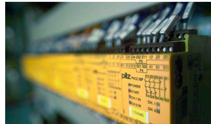
Schaltschrankbau inkl. Softwareprogrammierung.
